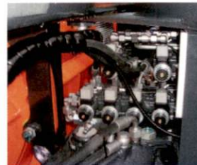
Hydraulikblock für Steuerung am Schneepflug
